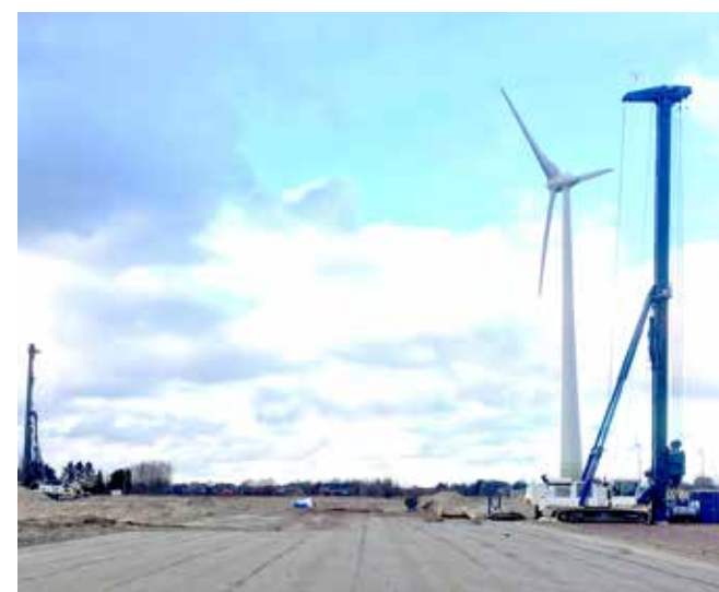
Votquenne Foundations heeft het voorbije jaar de fundering geplaatst van vijftien windmolens.
