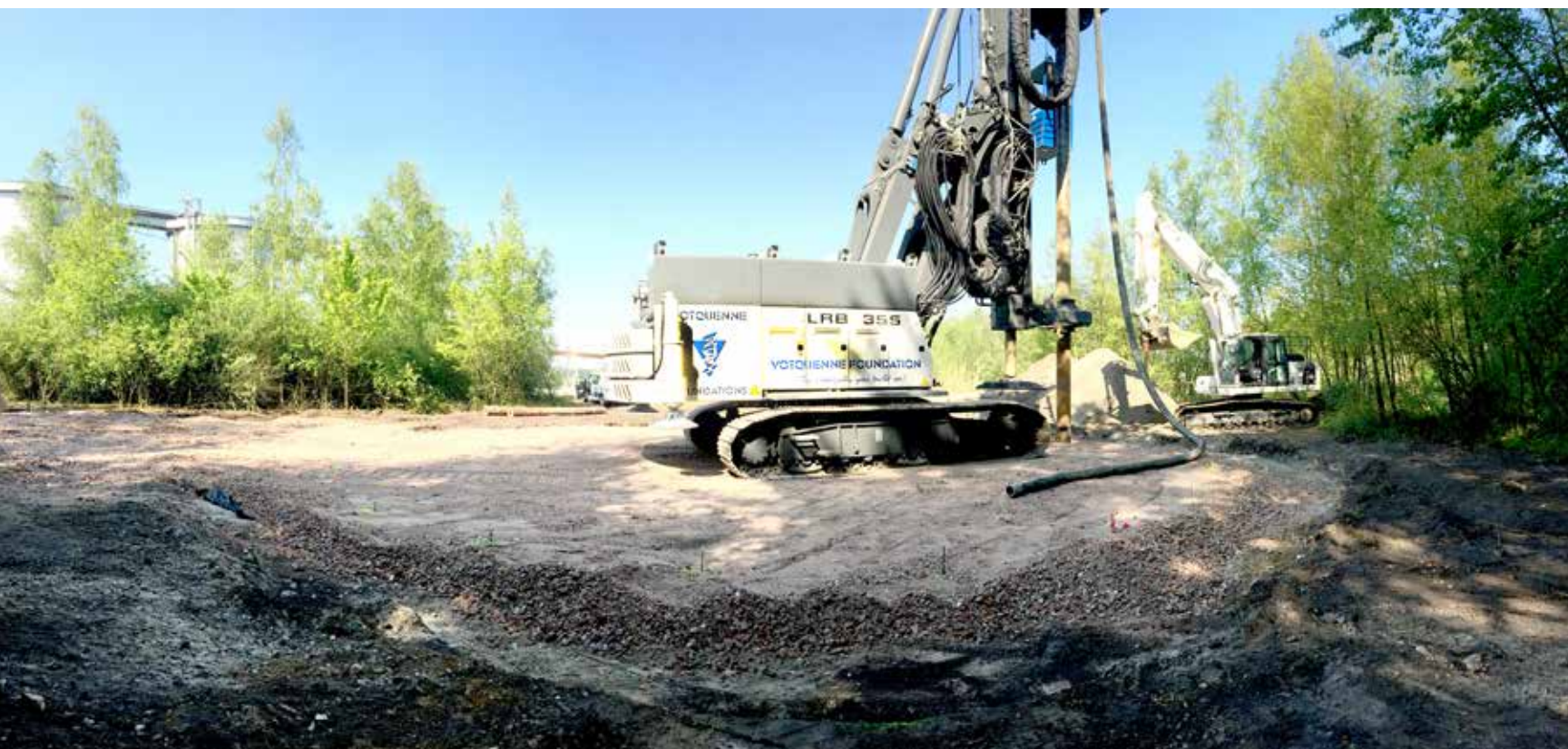
Om de funderingen van windmolens te plaatsen, zijn machines van het zwaarste kaliber nodig, zoals deze Liebherr LRB 355.
